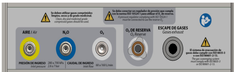
Imagen 4-5. Panel de conexiones neumáticas (*)
